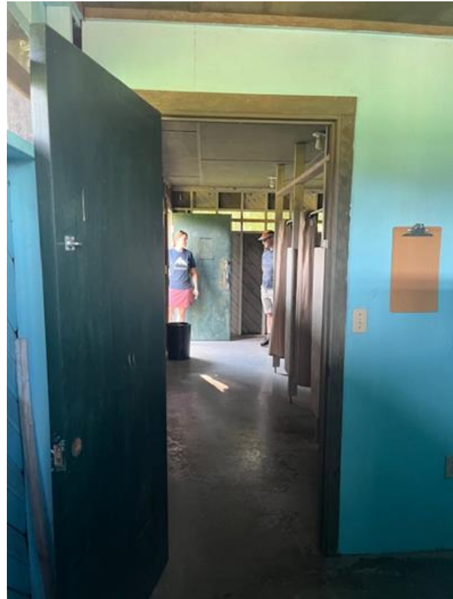
DOORWAYS – NOT ADA ACCESSIBLE
